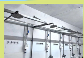
空气能热水淋浴设备
